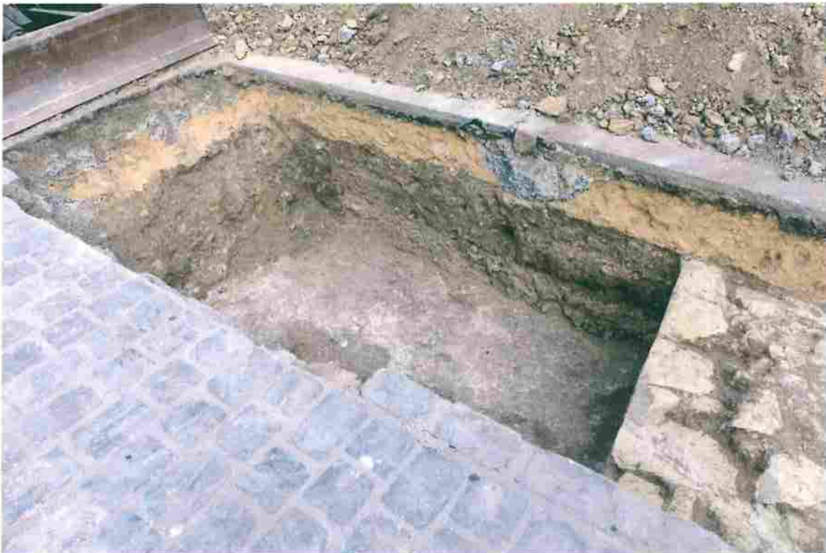
Fig. 17 : Vue de la cuve d'extinction de chaux UE 12 depuis le sud-ouest. Son creusement vient recouper à droite une épaisse couche de remblai (UE 13).
